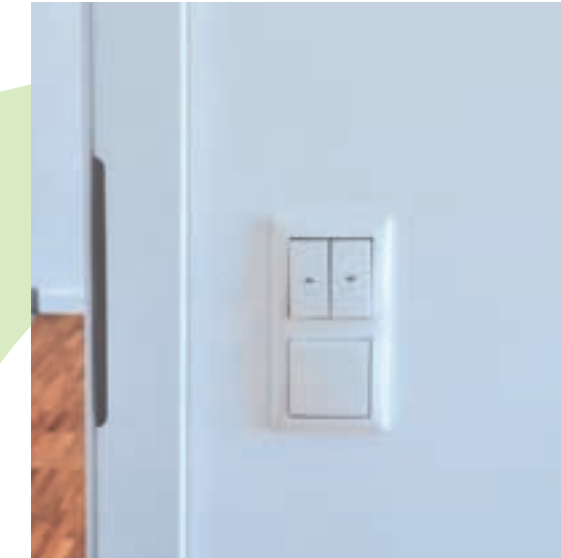
Ökostrom für die komplette Wohnanlage
